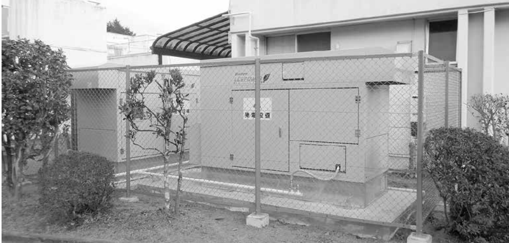
非常用発電機
